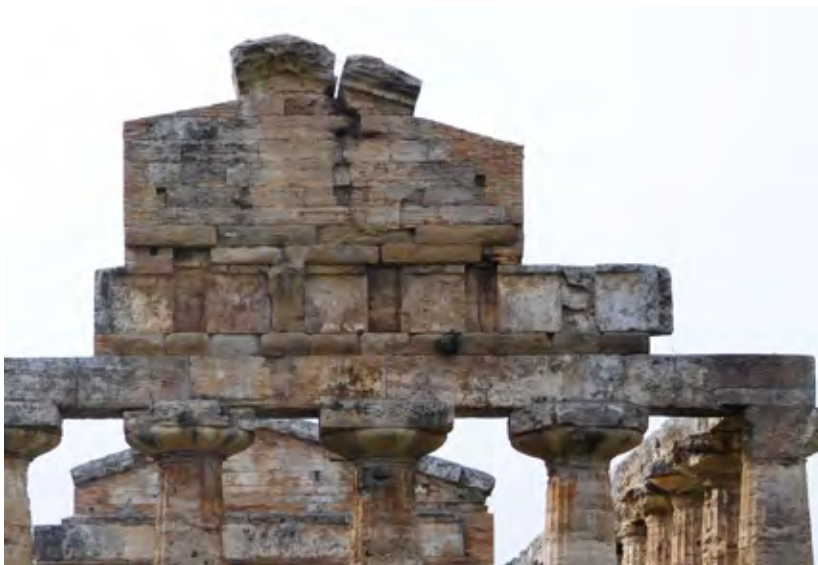
Figura 13. Paestum, tempio di Atena. Fronte orientale. Dettaglio delle integrazioni nel timpano eseguite dall'architetto Ciro Cuciniello con «fabbrica moderna» di mattoni in laterizio (foto S. Pollone, 2016).
