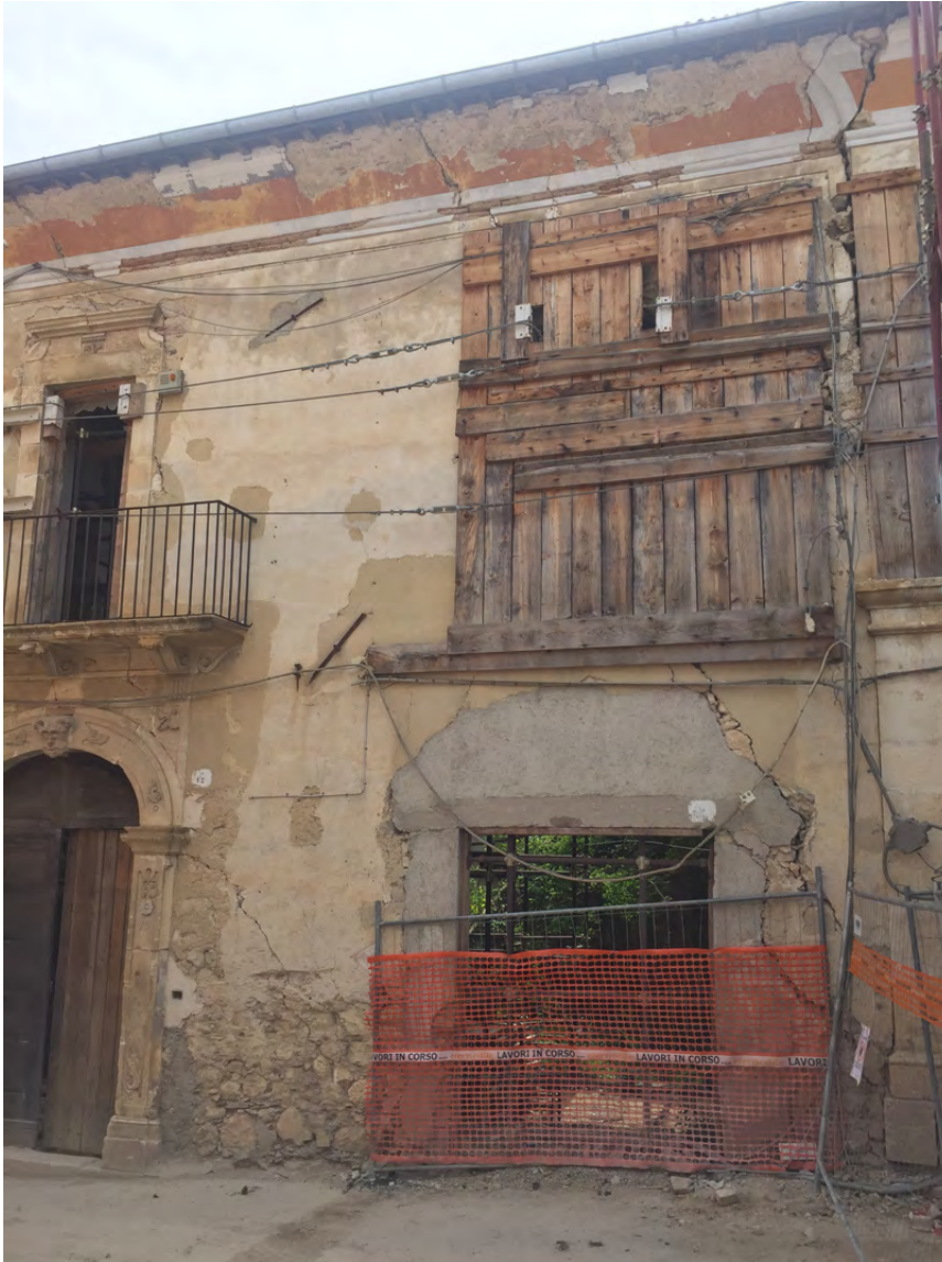
Figura 7. Villa Sant'Angelo (AQ), palazzo De Matteis in via Madonna delle Prata, giugno 2020. L'apertura di un garage sul fronte dell'edificio, in prossimità dell'angolo, ha ridotto la sezione resistente della muratura e concentrato i carichi sulle porzioni residue gravemente lesionate dalle sollecitazioni sismiche (foto C. Bartolomucci, 2020).
