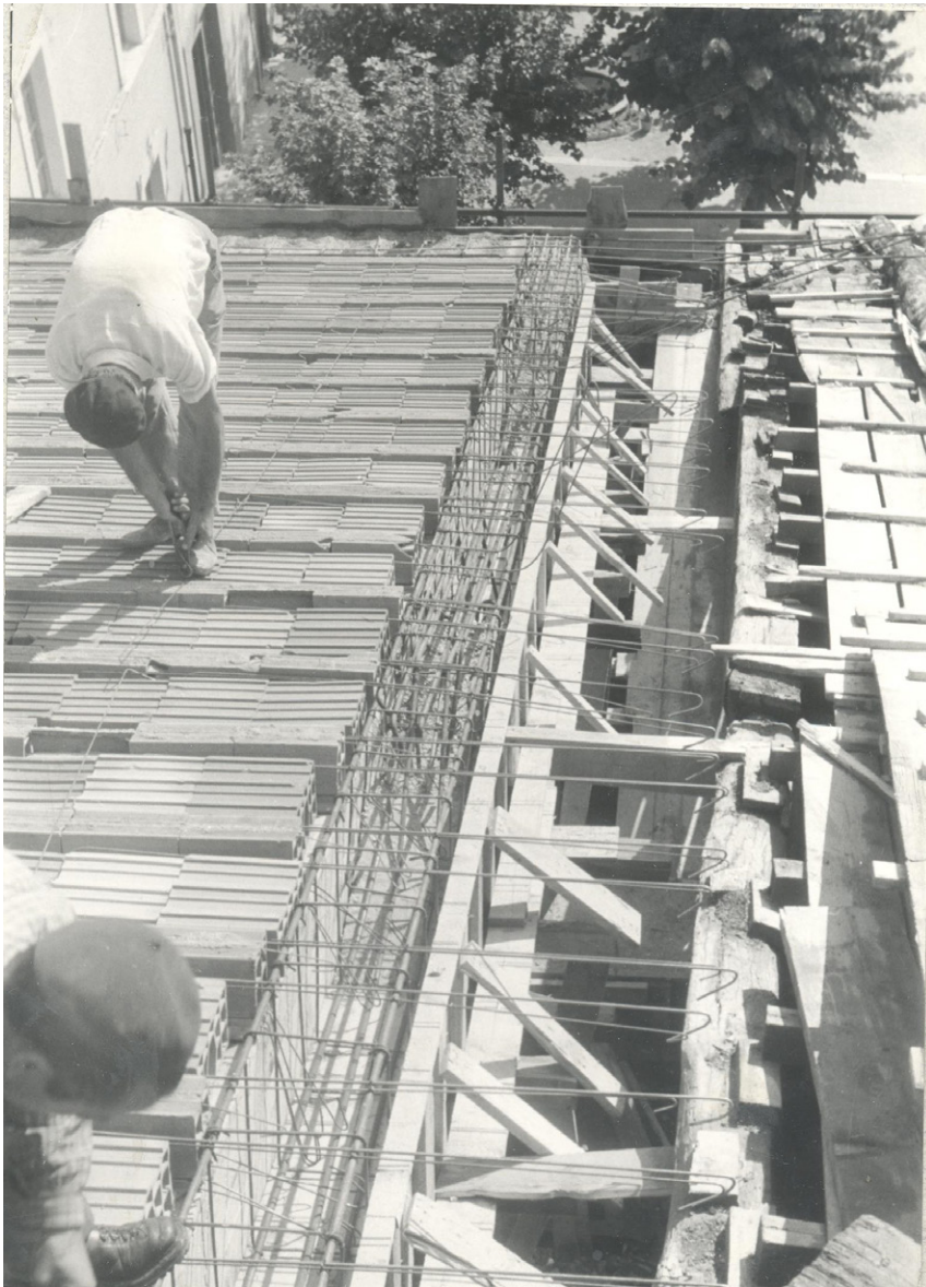
Figura 12. L'Aquila, basilica di San Bernardino. Il rifacimento delle coperture fu compiuto sostituendo la struttura lignea con solai in laterocemento e cordoli in calcestruzzo armato. SABAP-AQ, archivio fotografico, neg. 7741, anno 1960. Uso immagine su autorizzazione del MiC – Soprintendenza ABAP per le province di L'Aquila e Teramo (SABAP-AQ).
